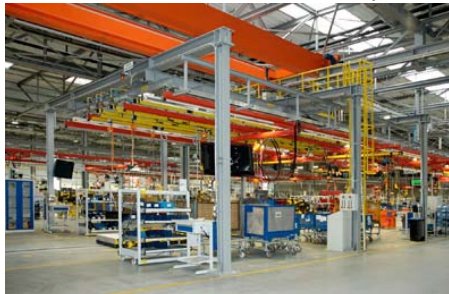
BU: Das modernste LKW-Werk Europas: Wampfler realisierte die Aufhängung und Versorgung aller Montage-Werkzeuge in den jeweiligen Bandabschnitten mit den erforderlichen Energien.
