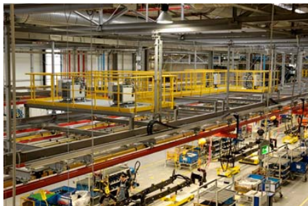
BU: Für MAN entwickelte Wampfler eine komplexe Deckenkonstruktion.
