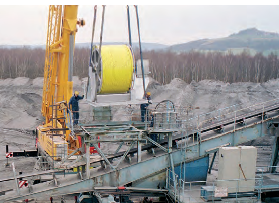
Von der Projektierung, über die Vormontage bis zur Installation vor Ort begleiten die Conductix-Wampfler Spezialisten ihre Kunden – überall auf der Welt!
