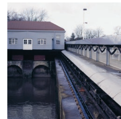
Tore auf! Leitungswagen-System Programm 0330 auf einer Schleusenanlage
